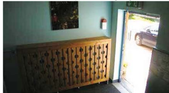
verkleidete Heizkörper im Eingangsbereich
