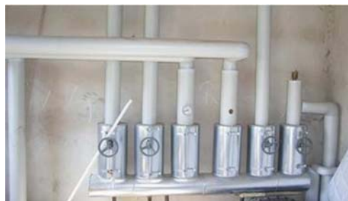
Heizkörper teilweise verstellt
