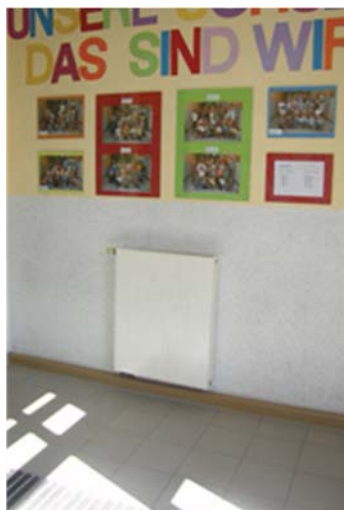
Heizkörper im Windfang
