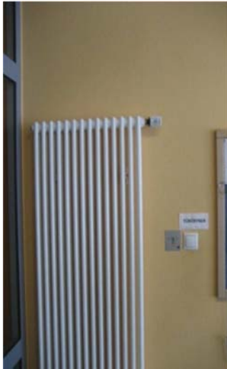
Heizkörper im Windfang
