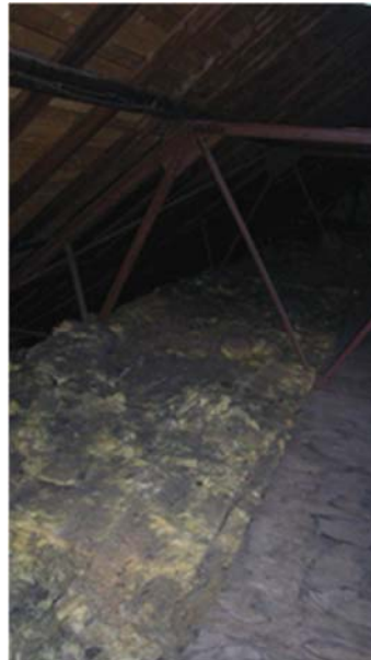
Dämmung oberste Geschoßdecke teilweise zerstört
