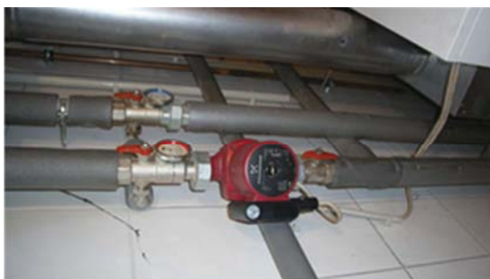
unzureichende Dämmung der Armaturen und Pumpen
