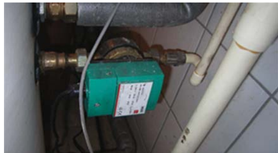
Pumpe der Warmwasserzirkulation
