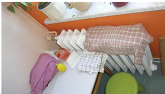
Heizkörper teilweise verstellt
